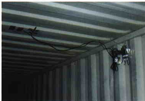
温湿度計測器のコンテナ天井面への設置例
