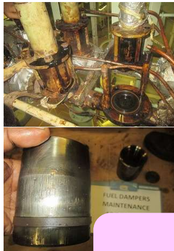
Fuel Dampers (pressure regulator) 不調によるOvershoot
